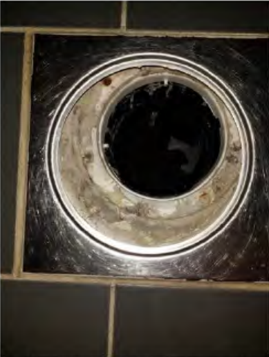
Kommentar - [Sluk, vaskerom ]
