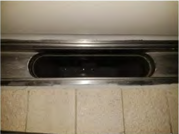
Kommentar - [Sluk bad, 1.etasje ]
