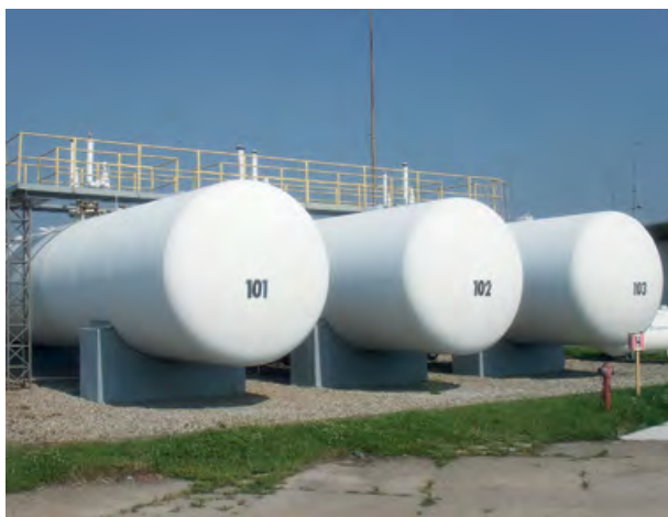
Jedną z najpopularniejszych metod przechowywania LPG w składach oraz obiektach klienta, są nadziemne zbiorniki cylindryczne.
