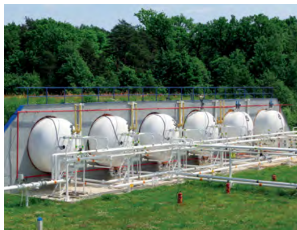
Zbiorniki LPG znajdujące się w nasypach zwiększają bezpieczeństwo w stosunku do czynników zewnętrznych, takich jak oddziaływanie płomieni, w przypadku pożaru w pobliskim otoczeniu.
