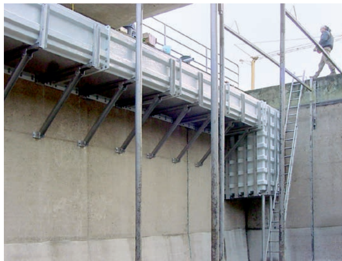
Rinne mit Ablaufschacht
