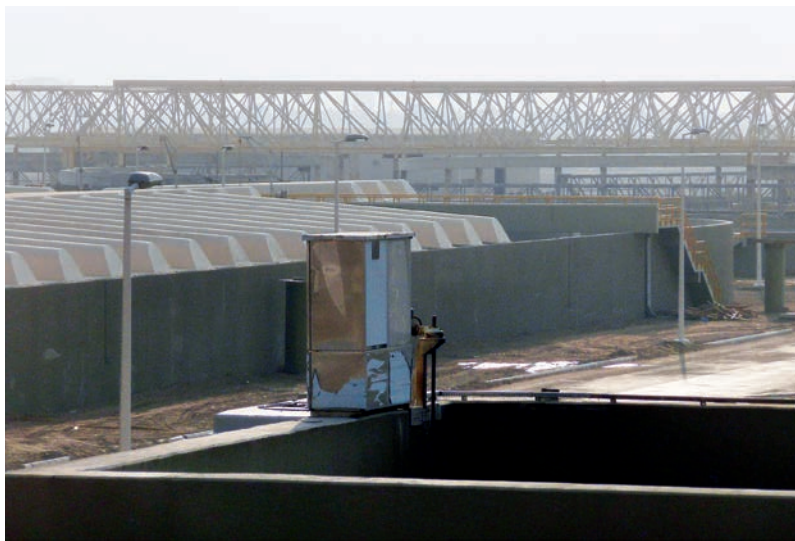
Jeddah North (KSA), 8 Becken, Fläche 8 \times 2500 \text{ qm} , Binderspannweite bis 56 m, Elementspannweite bis 7,8 m
