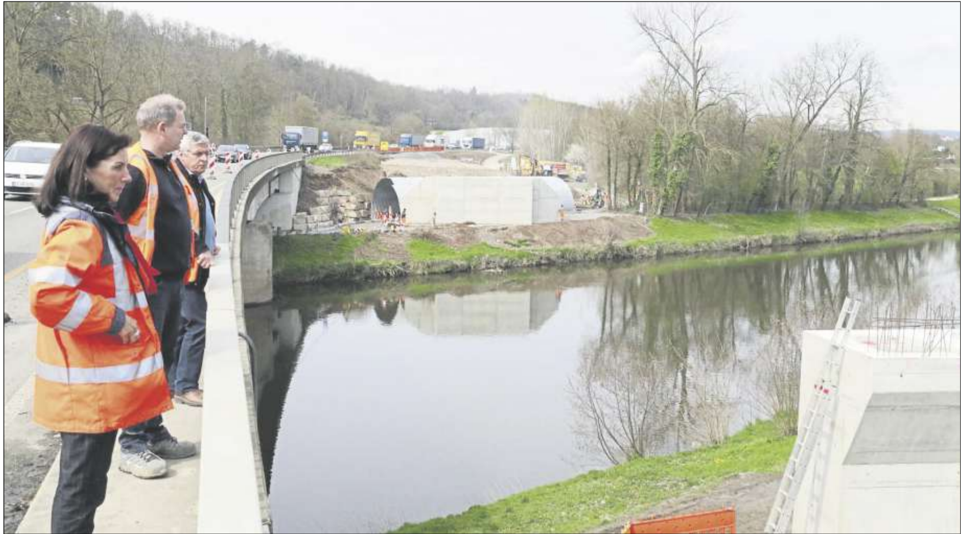
Ulrike Conle, Walter Burgmaier und Manfred Feyrer schauen von der maroden B 10-Brücke auf die Widerlager, wo in den nächsten Wochen die Behelfsbrücke eingeschoben wird.
