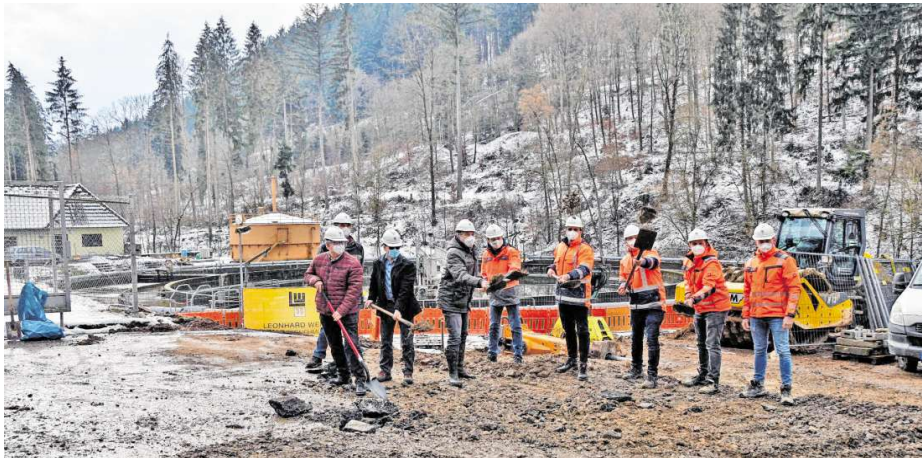
Offizieller Beginn der Erweiterungsarbeiten in der Kläranlage des Abwasserzweckverbands Hardheim-Höpfingen: Zur Schaufler griffen neben dem Verbandsvorsitzenden Volker Rohm und dessen Stellvertreter Adalbert Hauck auch Geschäftsführer Bernd Schretzmann, Daniel Berger (Leiter der Kläranlage) und Thomas Withopf (bautechnischer Bereich). Unterstützt wurden sie von Vertretern des Ingenieurbüros Klinger und Partner sowie des Bauunternehmens Leonhard Weiss.
