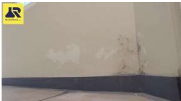
Dompage à cause d'humidité ascensionnelle
