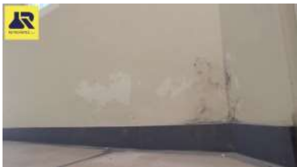
Schade opstijgend vocht
