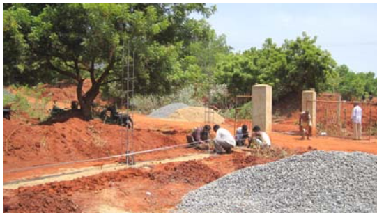
Baumaterial liegt bereit, die ersten Armierungen für die zu giessenden Pfeiler sind in den Bohr- löchern. Das Land wird neu vermessen: Landgewinn ca. 1000 m 2
